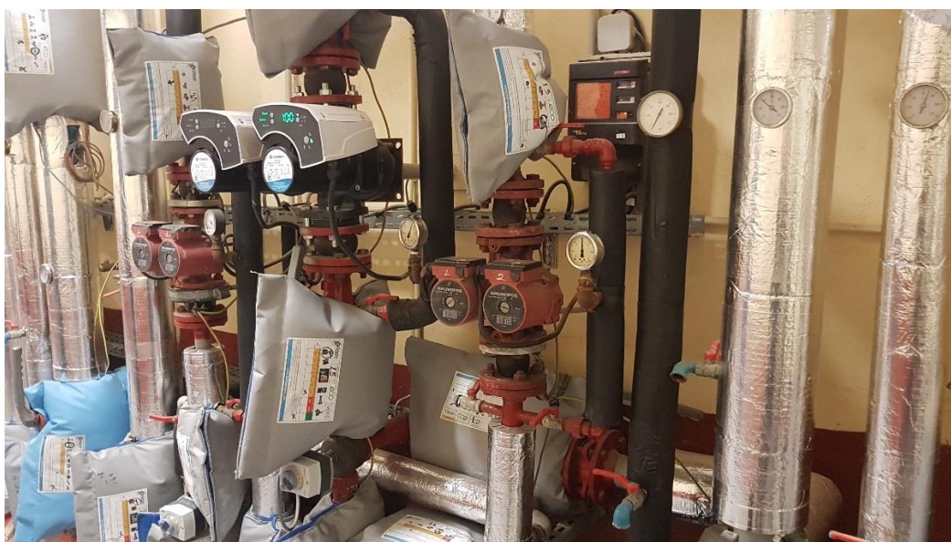
Compteur d'Energie de l'Ecole Berthelot
