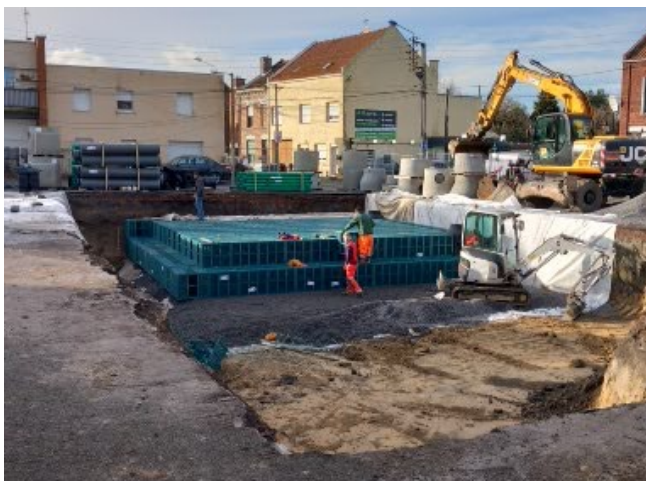
Réalisation d'un bassin d'infiltration d'un volume utile de 278 m 3 sur la place Charles Mathieu
